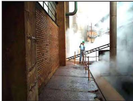
FIGURA 1 - Deterioração de pilares por ataque químico.
