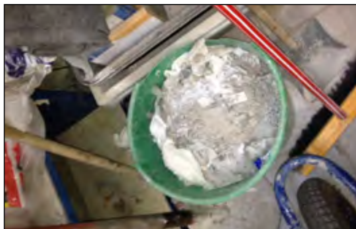
FIGURA 7 - Armazenamento temporário de resíduos da construção civil, agregados e varrição.
