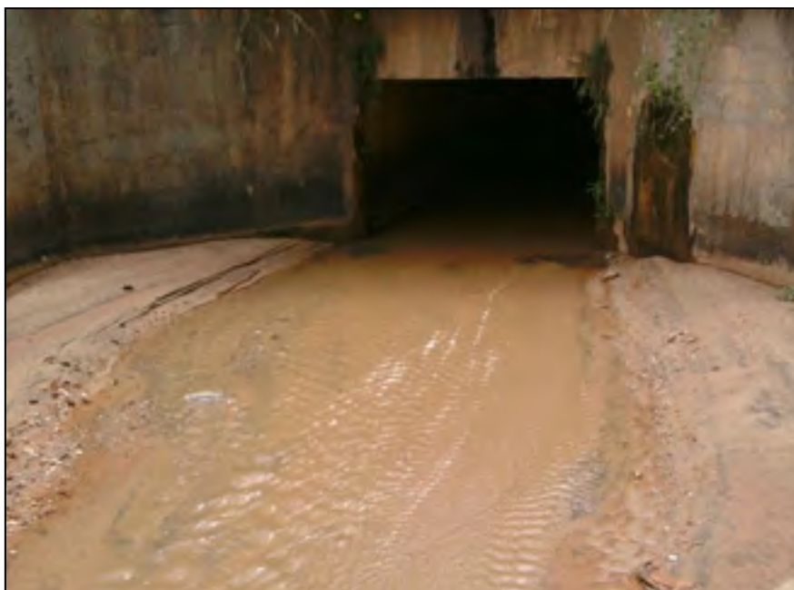
FIGURA 8 - Assoreamento do canal do córrego do Pintado na área da REGAP.
